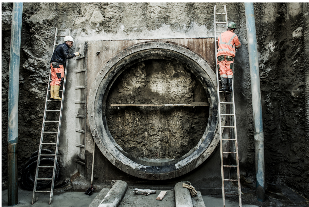
Damhusledningen - en bassinledning. Foto: HOFOR
